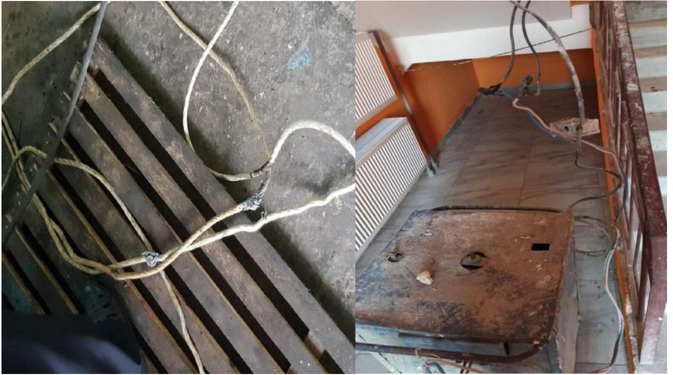
Не закрыты токоведущие части проводов.
