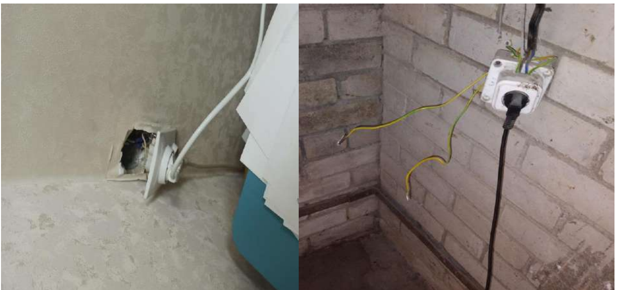
Не закрыты токоведущие части розеток.
