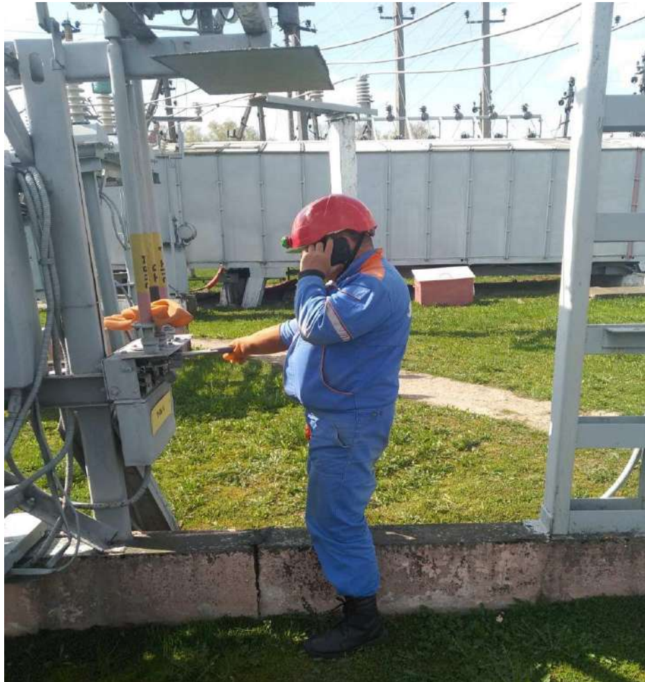
Нарушение требований локального правового акта по охране труда (разговор по мобильному телефону во время оперативных переключений).
