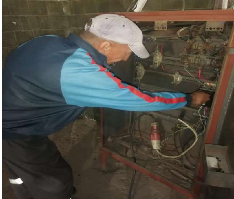
Выполнение работ без применения СИЗ.
